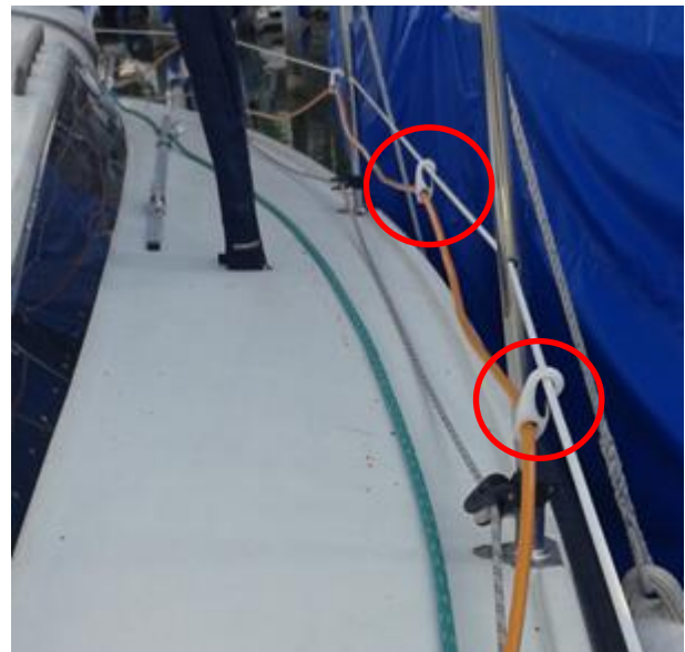
Bild 40: Landstromkabel mit Aufhänge-Hacken
