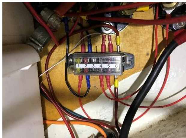
Bild 45: Sicherungen im Batteriefach
