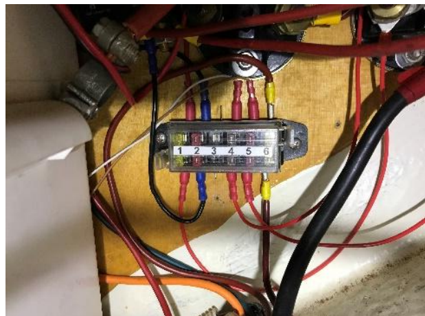
Bild 45: Sicherungen im Batteriefach
