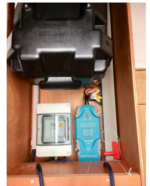
5. Ladegerät und Schutzschalter
