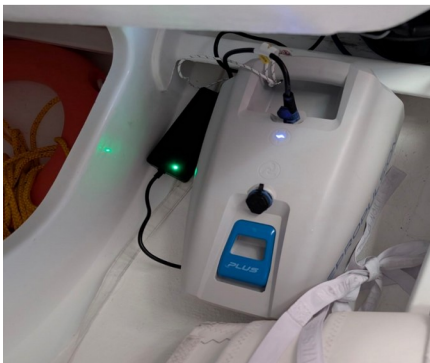
Batterie mit Ladegerät u. Kontrolleuchten
