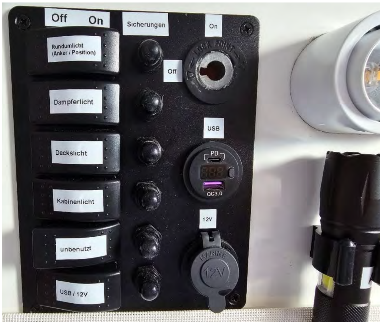
Bordelektrik für Lichter und USB-Steckdosen, LED-Kabinenlicht .
