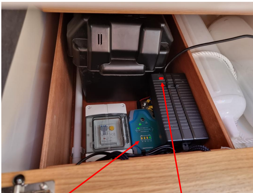
Ladegerät Bord Batterie mit Kontrolllampe und Akkustand
