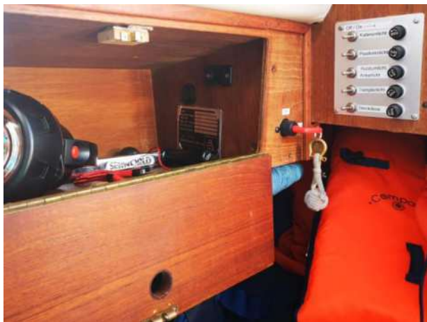
Schalttafel, links davon der Hauptschalter. Im stb Schrankfach befinden sich 2 USB Anschlüsse sowie eine 12 V Steckdose für Zigarettenstecker.
